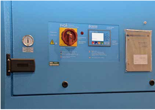
Am Display am Klimatower lassen sich die Sollwerte für die automatische Raumluftregelung einfach einstellen.
