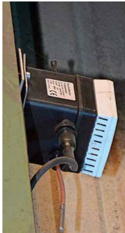
Ein Sensor oberhalb des Arbeitsbereichs, knapp unter der Hallendecke, erfasst dort die Luftbelastung und sendet die Daten an die SPS des Klimatowers.
